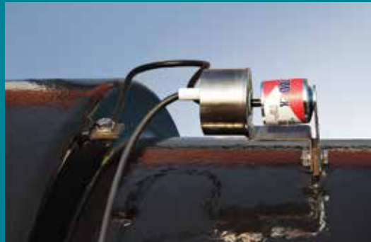
Датчик МКИ на искроразряднике
